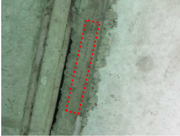
① 바닥판하면 S12 보수부 철근노출
