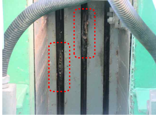
② 신축이음 P12 고무재 파손
