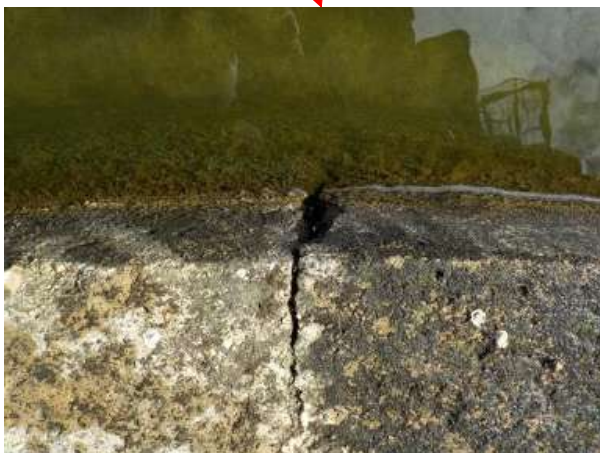
② 교각 P11 기초 파손
