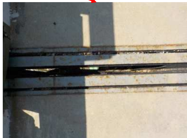
③ 신축이음 P12 본체 고무재 파손
